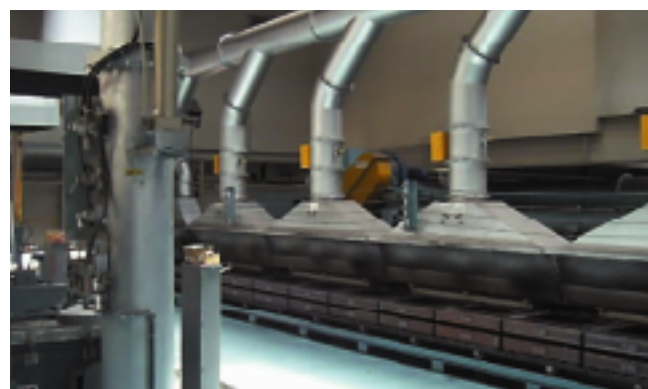
▲照明レスの造型ライン
